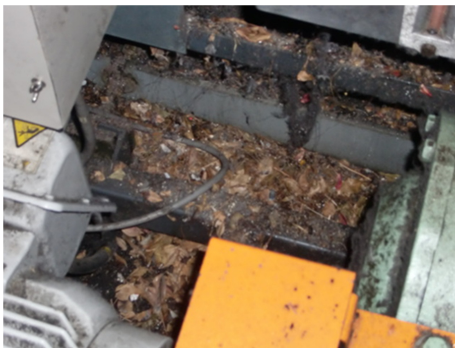
写真 2-1-2 機械室内に落ち葉等が蓄積している例
