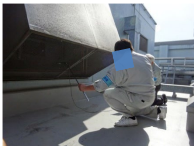
煙排出口の風速測定状況
