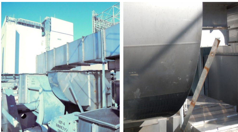
支持金物の脱落事例
