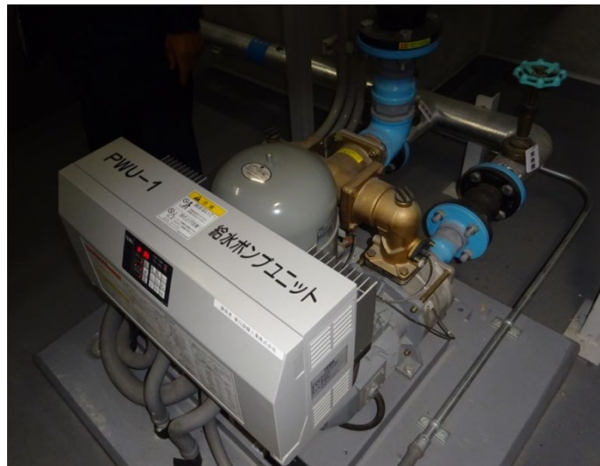
給水ポンプユニットの例
