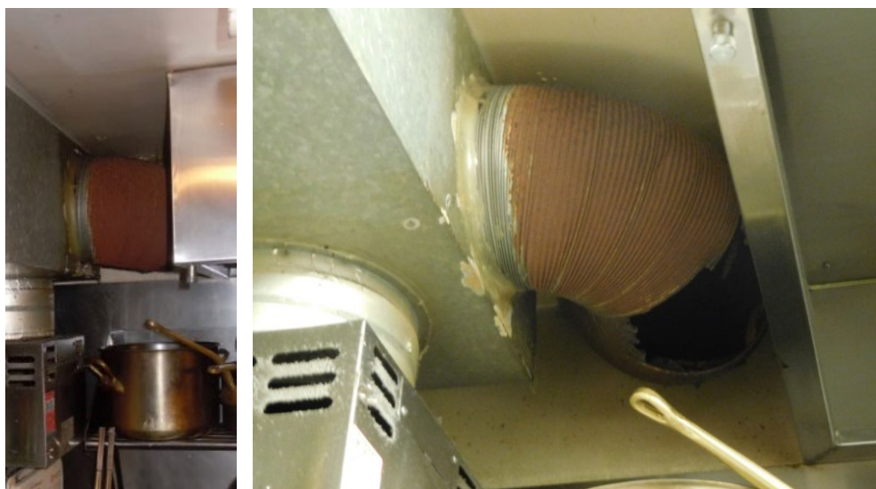
排気筒の破損事例
